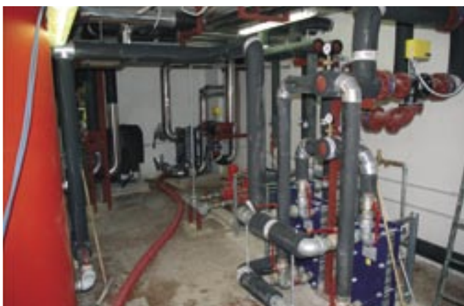
Scambiatori a piastre e serbatoi inerziali Exchanger plates and shells inertial
