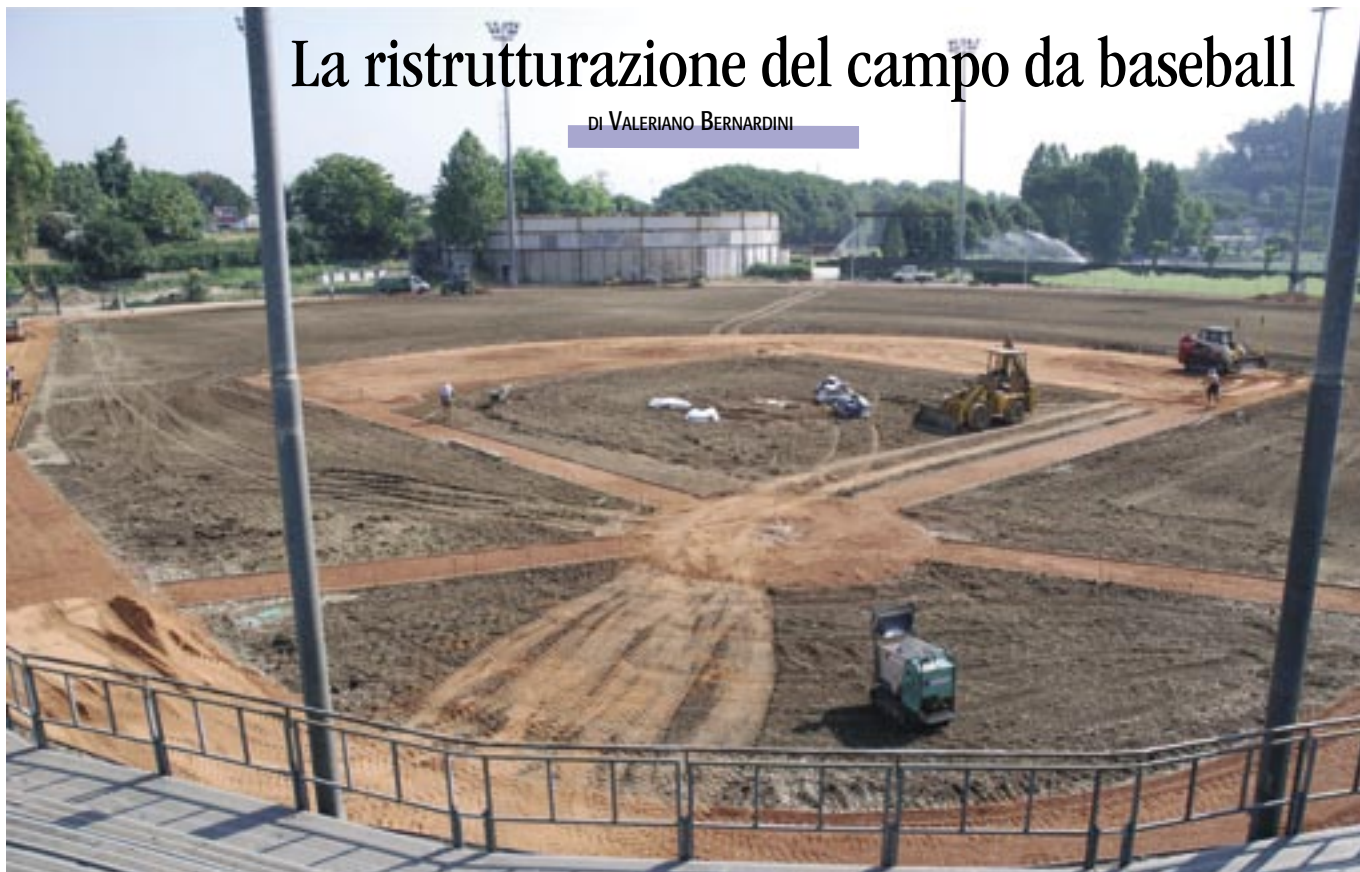
Realizzazione dell'infield e della warning-track in terra rossa The construction of the red clay infield and warning track
