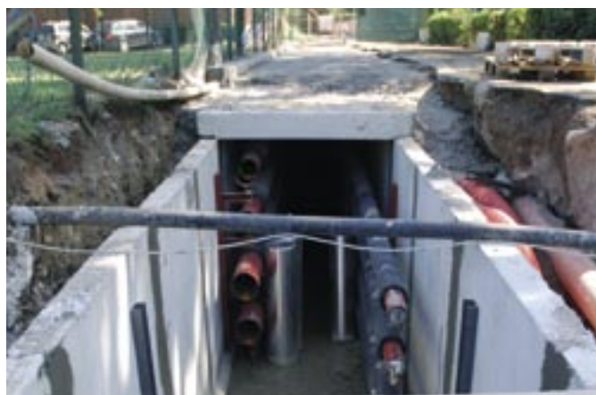
Distribuzione fluidi dalla nuova CTF agli altri edifici Distribution fluids from the new thermal power plant to the other buildings
